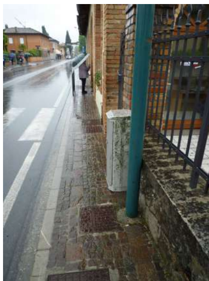
Fig.10 Marciapiede con restringimento per presenza contatore.
