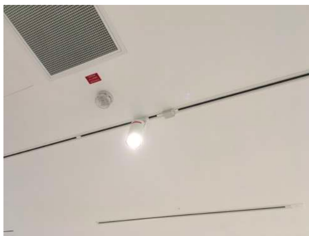
Fig.23 Beacon installato nel canale di supporto luci.
